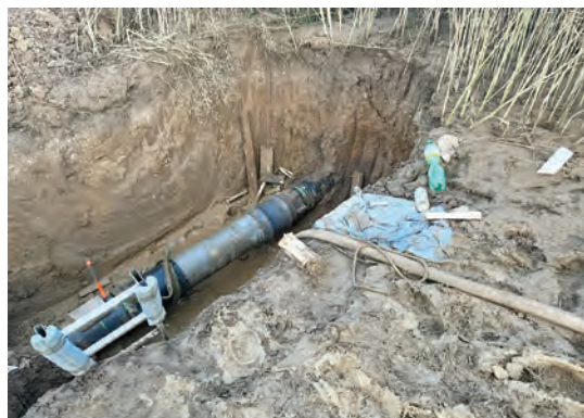
Porucha na vodovodním přívaděči
