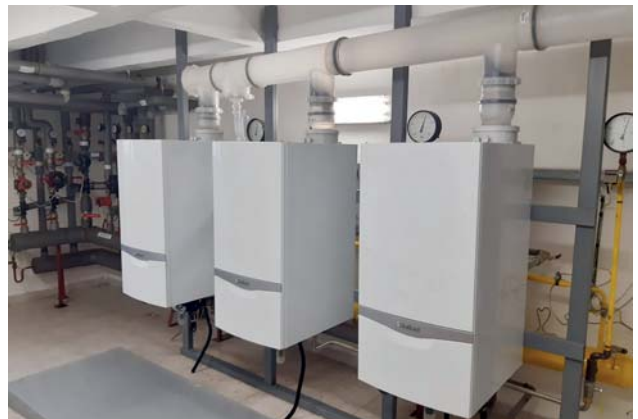
Rekonstrukce plynové kotelny – nový stav
